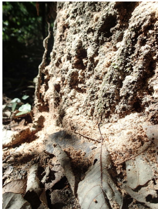
穿入孔から 大量の木屑（フラス）
